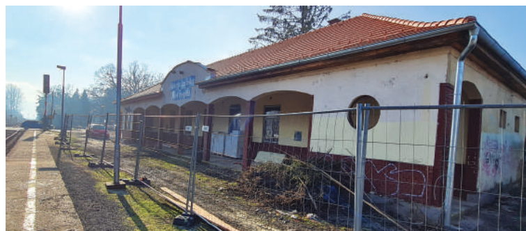
Budova zastávky je počas prác oplotená a pre cestujúcich neprístupná. Foto: kmk
